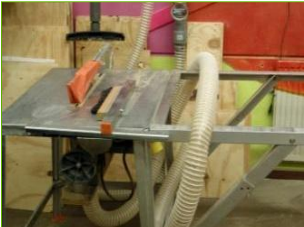
Op de ringleiding van de nieuw geïnstalleerde houtstofafzuiginstallatie zijn 4 machines aangesloten.
